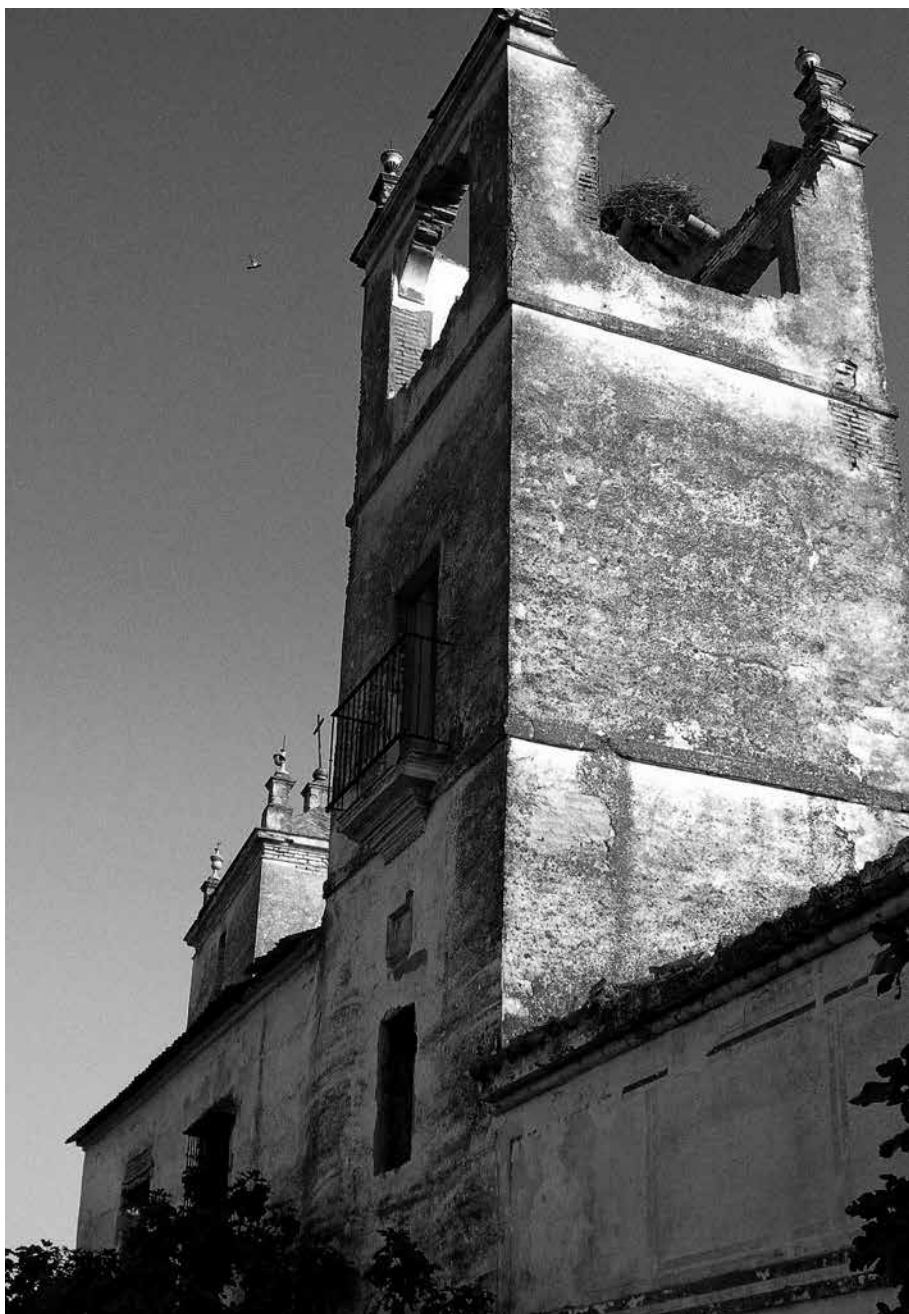
Fig. 8. Fachada posterior. Torre mirador con cuerpo superior mutilado por la sustracción de las columnas y fachada trasera del señorío con esgrafiados. Estado de conservación en el año 2010. F. Bejines.
